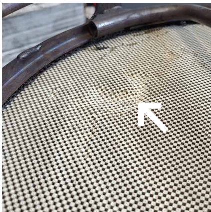
Uszkodzenie mechaniczne, wgniecenie
